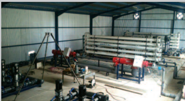
Planta de osmosis inversa construida en la planta potabilizadora
